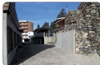
• Pont de Bachat Bouloud • Stabilisation des gabions. 11 000 € (participation de l'Ecrin des Neiges: 5 000 €)
