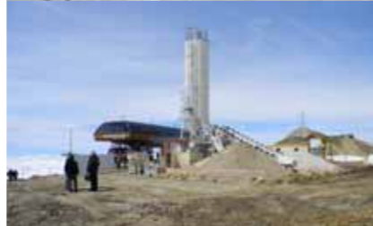
La centrale à béton
